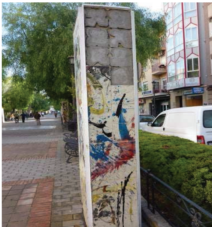
Ilustración 6. Paseo de Cieza, Murcia. José Lucas Ruíz (1986). Detalle de daños
