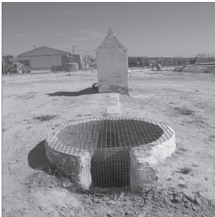
FIGURA 15. Poceta de decantación. Casa Nuevas.
