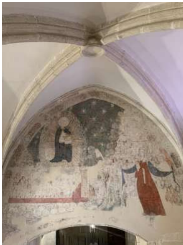
Figura 44. Vista desde la segunda planta a los restos de pintura mural del siglo XV. Fuente: elaboración propia.
